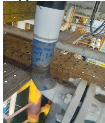
Gambar 2. Kondisi Pipa Sebelum dilakukan Perbaikan
